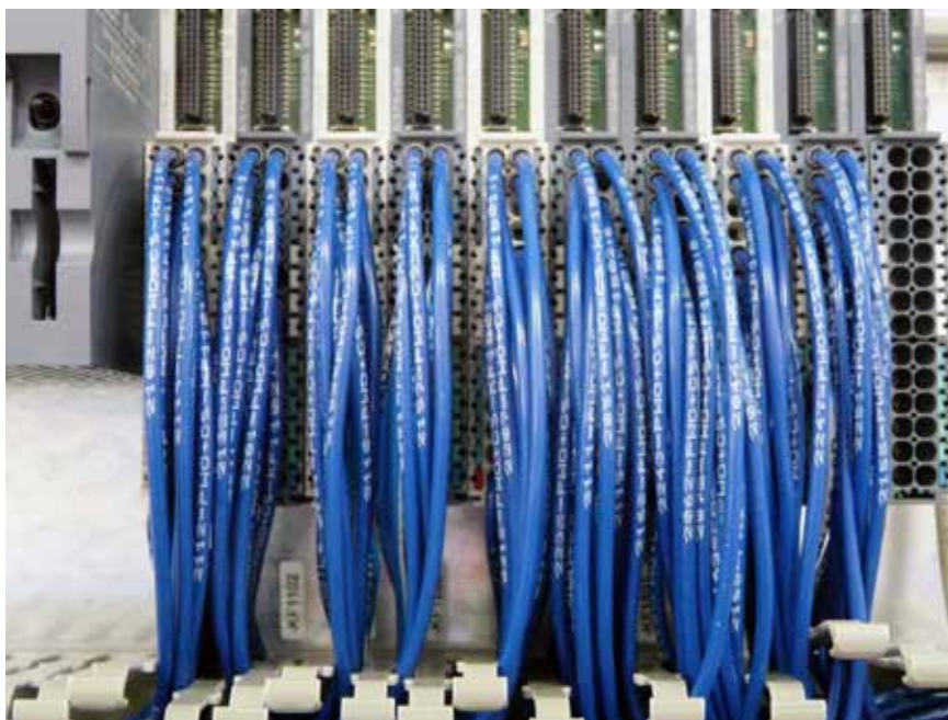
Die Kennzeichnung der Kabel erfolgt bei Alexander Bürkle automatisiert und aus Eplan heraus.
