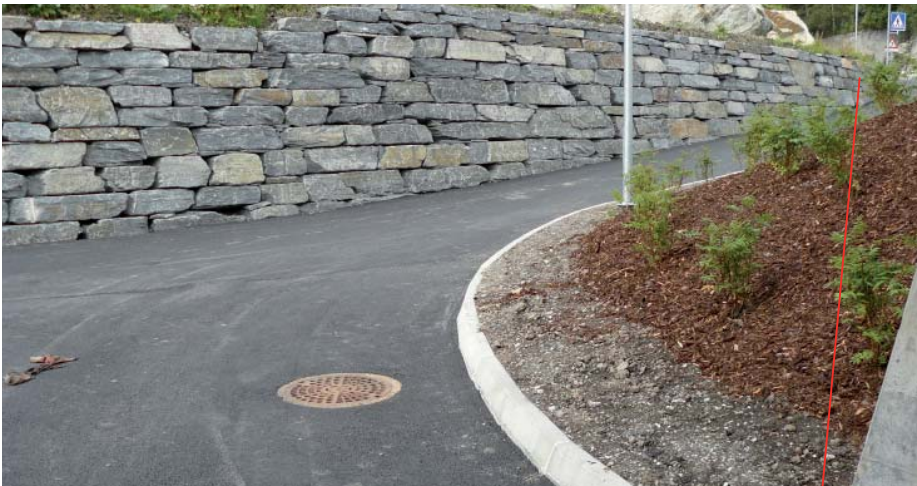
Utvidet siktzone fra kulvert. Påse at man sjekker ut siktsoner ekstra her i forhold til beplantning. I dette tilfellet er ikke siktsoner ivaretatt pga. terrengoppbyggingen her (Foto: Nina Fredriksen).
