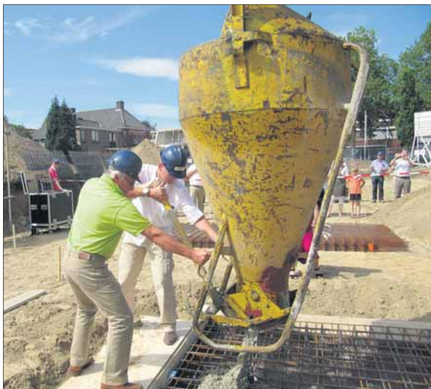
Rob Jansen v.d. Berg en Ben Albers storten beton voor de liftput
