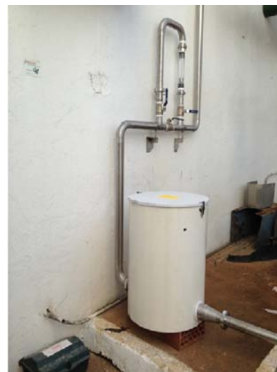
Imagen 4: Instalación del equipo en los baños o distintas fases de lavado del tomate.
