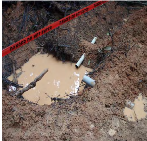
Figure 2. Puisard de liquides de forages avec débordement.
