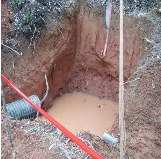
Figure 1. Puisard de liquides de forage.
