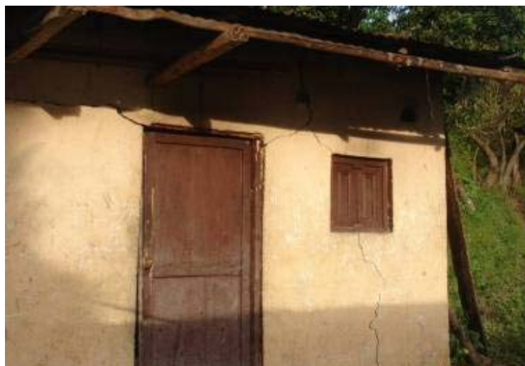
Foto No. 18 - Agrietamientos en la escuela Buricí
