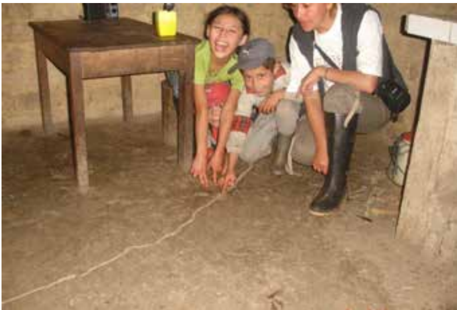
Foto No. 9 - Daño y agrietamiento de viviendas en el sector de Sismosá
