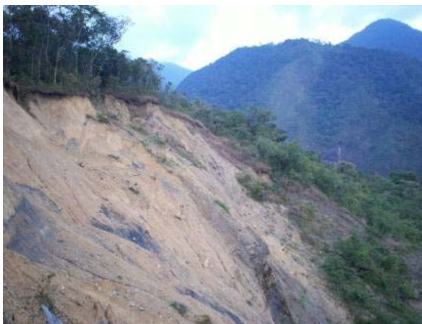
Foto No. 16 - Deslizamiento sobre la quebrada Buricí
