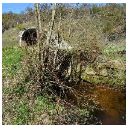
Canalizacións e eliminación de masas autóctonas en marxe de ribeira a carón de infraestruturas (Monte de Corzos)
