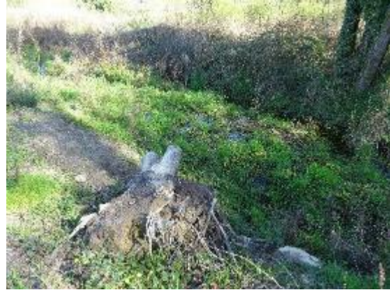
Canalización da rede de drenaxe entre a estrada e o noiro de recheo eliminando a vexetación natural.
