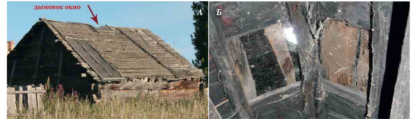
Рис. 14. Священный дом Тырлина в поселке Хошгорт. А) В верхней части кровли небольшое отверстие для дымоудаления (дымовое окно). Б) Вид отверстия для дымоудаления внутри постройки
