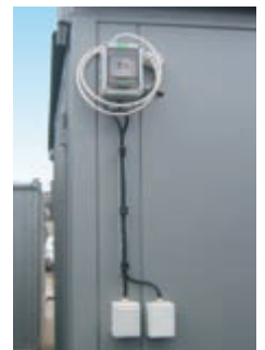
Detail der Elektroinstallation
