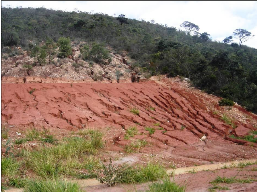
Figura 3.41 – Desenvolvimento de processos erosivos concentrados em áreas de intervenção de corte e aterro
